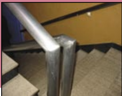
Figura 328 – Corrimão descontínuo provoca a perda de equilíbrio em diversas pessoas pela interrupção do apoio. No caso das Rotas de Fuga esta situação é perigosa.
