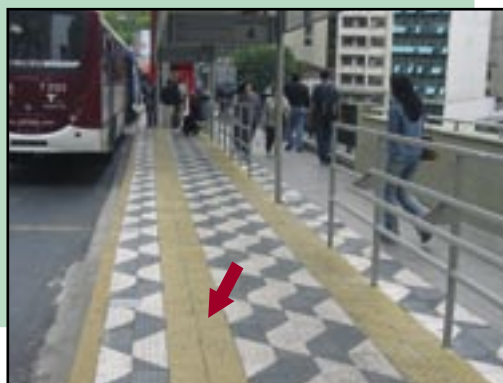
Figura 205 – Parada de transporte coletivo com faixa de orientação com textura e cor diferenciada do restante do piso, facilitando a circulação e o acesso de pessoas com deficiência visual aos veículos.
