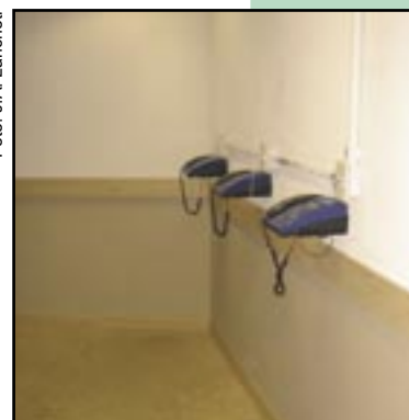
Figura 034 – Telefones instalados em área interna de edificação pública. Destaca-se que todos estão em mesma altura, permitindo que qualquer pessoa utilize qualquer um dos aparelhos.
