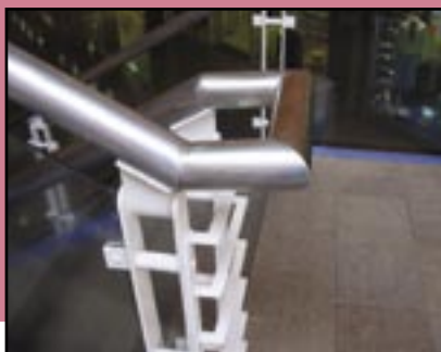
Figura 329 – Corrimão contínuo conforme recomenda a NBR, porém as quinas vivas resultantes da execução do mesmo podem causar acidentes.
