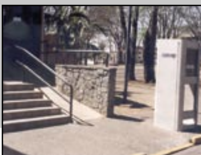
Figura 074 - Erro na definição da inclinação da rampa.
