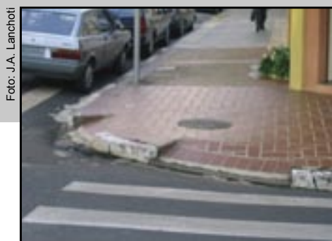
Figura 047 – A inclinação muito acentuada, fora do estabelecido na Norma NBR 9050:2004 e o material escorregadio transformam esta solução em um grande erro em termos de acessibilidade.
