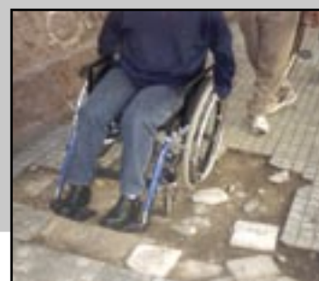
Figura 075 - Falta de manutenção do piso da calçada.
