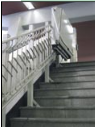
Figura 128 - Plataforma elevatória acoplada em corrimão de escada. Uma adaptação para situações já existentes.
