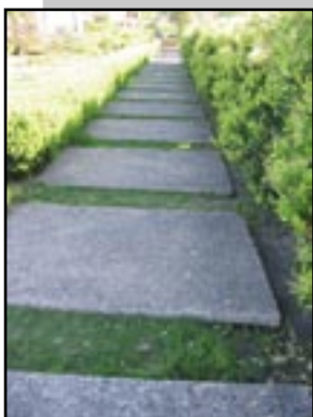
Figura 232 —Piso inadequado para a mobilidade acessível por estar descontínuo.
