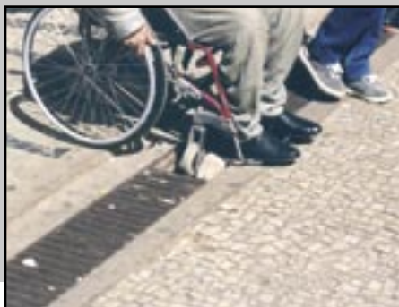
Figura 102 - Acidente com usuário de cadeira de rodas provocado por grelha solta no passeio público.
